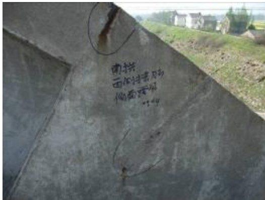
图 7.3.4 南侧拱肋侧面露筋图
