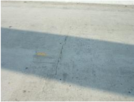
图 7.8.1 桥面横向开裂
