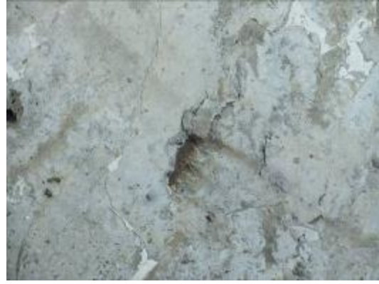
7.3.7 南侧拱肋东侧拱脚露筋照
