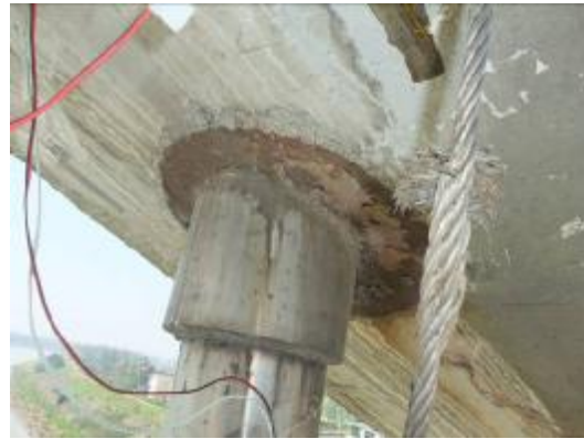
7.4.2 吊杆端部钢板锈蚀照
