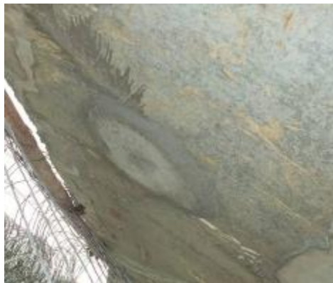
图 7.4.3 系梁底封锚混凝土表面照
