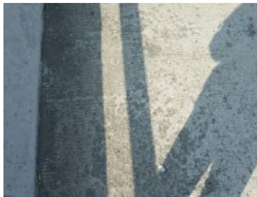
图 7.8.3 桥面磨损、粗骨料外漏
