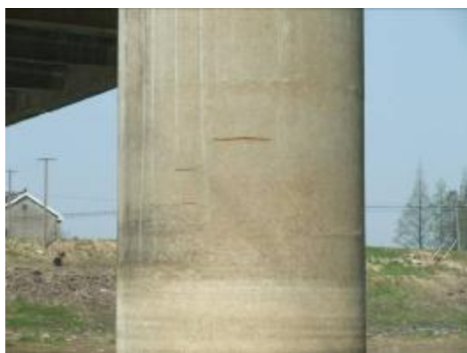
图 7.1.1 墩柱露筋照图
