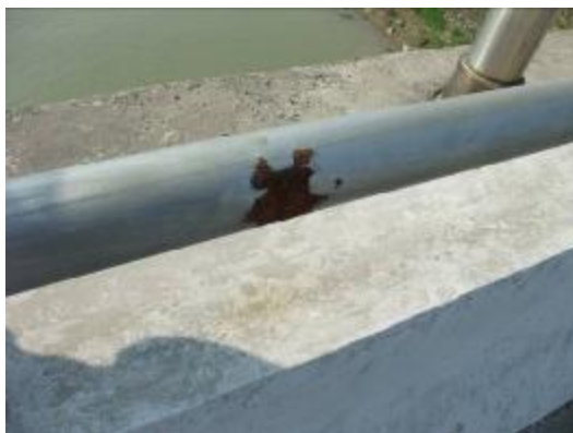
图 7.5.1 护栏钢管防护漆剥落
