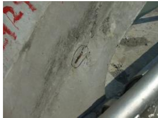
7.3.9 南侧拱肋东侧拱脚露筋照
