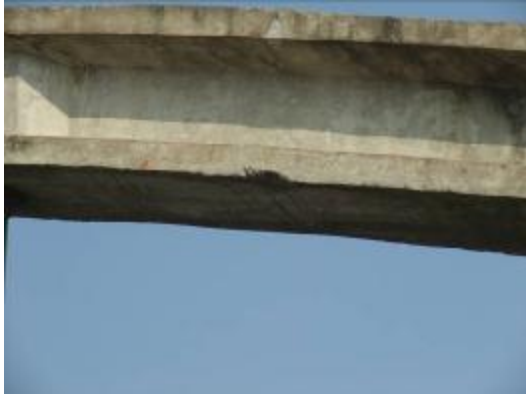
图 7.3.6 北侧拱肋砼破损照
