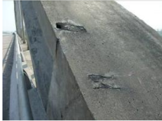
7.3.3 南侧拱肋混凝土夹杂木块
