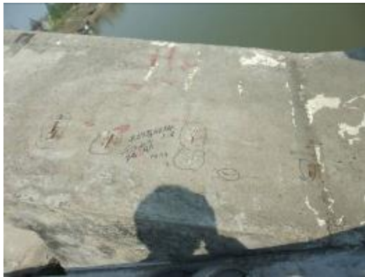
图 7.3.8 北侧拱肋东侧拱脚顶面露筋照
