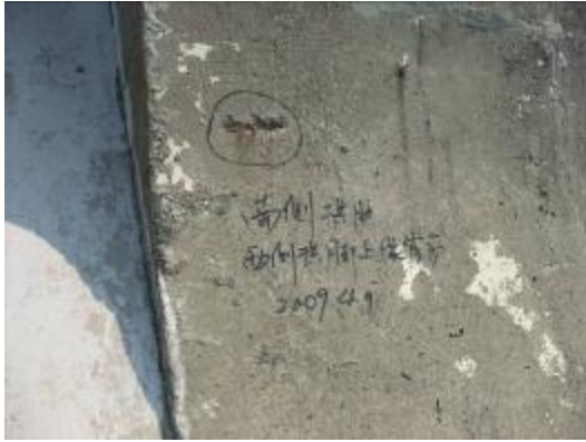
图 7.3.2 南侧拱肋西侧拱脚露筋图
